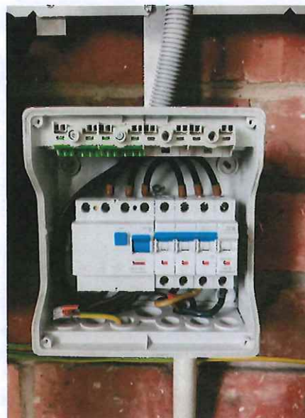
( Elektrisch bord - binnenkant )
