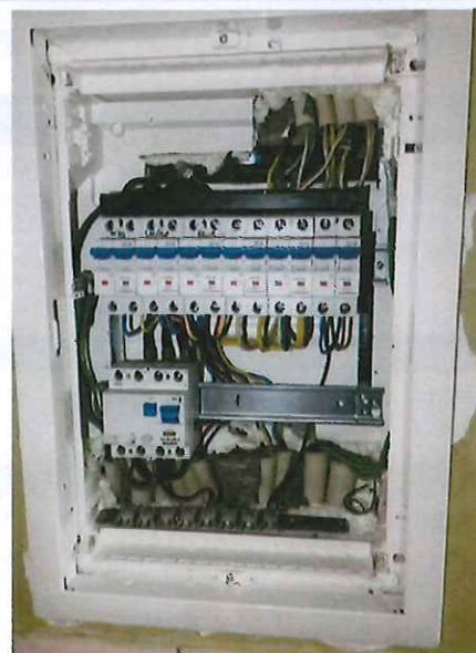
( Elektrisch bord - binnenkant )
